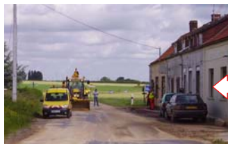
Nettoyage de la boue Par la DDE rue de Lillers 20 juin 2007
